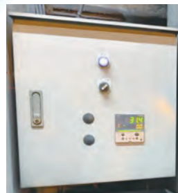
インバータ制御盤
